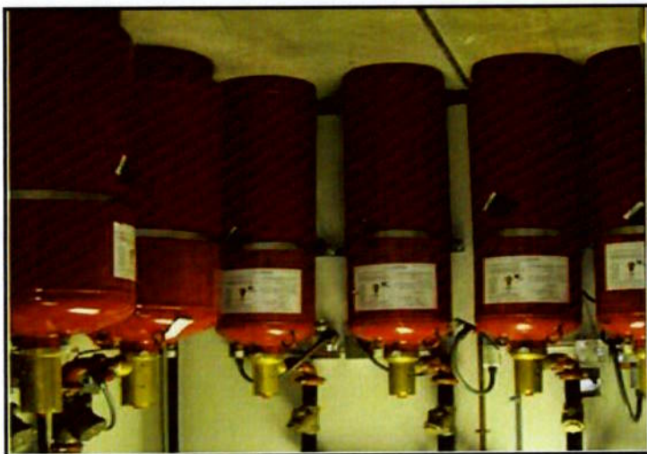
Figura 23 – Cilindro de Armazenamento Fonte: (ARGUS, 2011)
