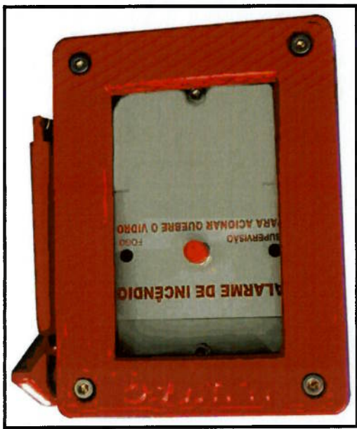
Figura 16 – Acionador Manual Fonte: (ILUMAC, 2011)
