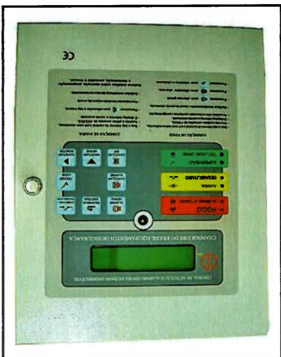
Figura 15 – Painel Central Fonte: (RMINCENDIO, 2011)
